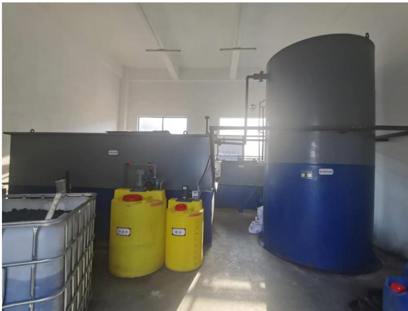
污水处理站预处理工序
