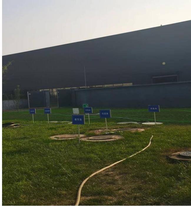
污水处理站地理生化处理工序
